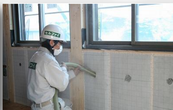
内断熱には木質繊維断熱材 「セルロースファイバー」
