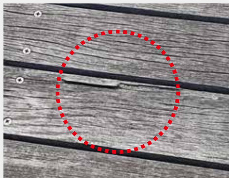
↑ ハードウッドの経年変化によるささくれの例
